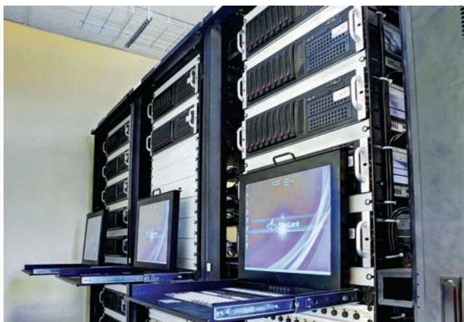
Серверное и кодирующее оборудование SkyLark
